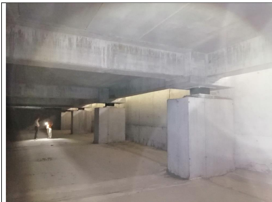
Fig. 1 - Il vano interrato dell'edificio dell'ospedale Gervasutta che separa la struttura di fondazione dai piani superiori mediante gli isolatori sismici.
