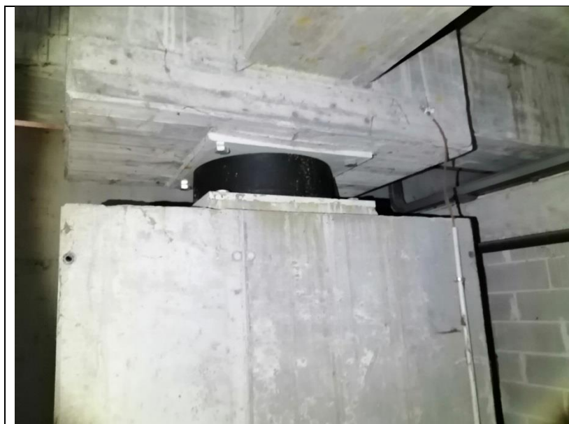
Fig. 2 - Un dettaglio di uno degli isolatori sismici montato su un pilastro in cemento armato e la sovrastante struttura a travi in c.a.
